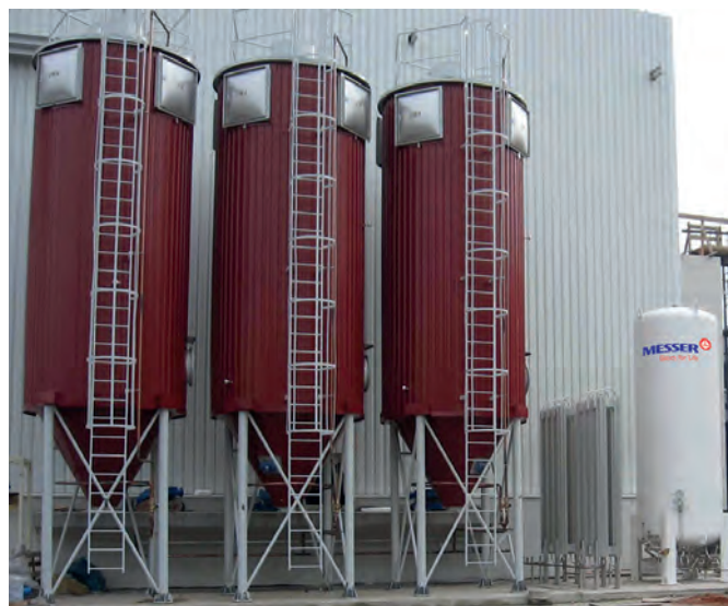
Obr. 4 – Instalace rychlé inertizace pro sila sušeného čistírenského kalu
