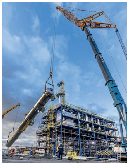
Obr.: Instalace rektifikační kolony
