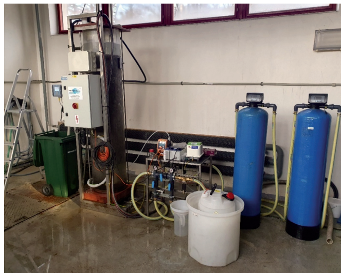
Obr. 1: Pilotní jednotka na ČOV Liberec.
