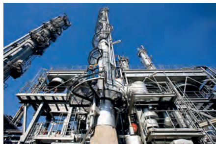
Obr.: Krakovací pec ve výrobním závodě BASF v Ludwigshafenu
